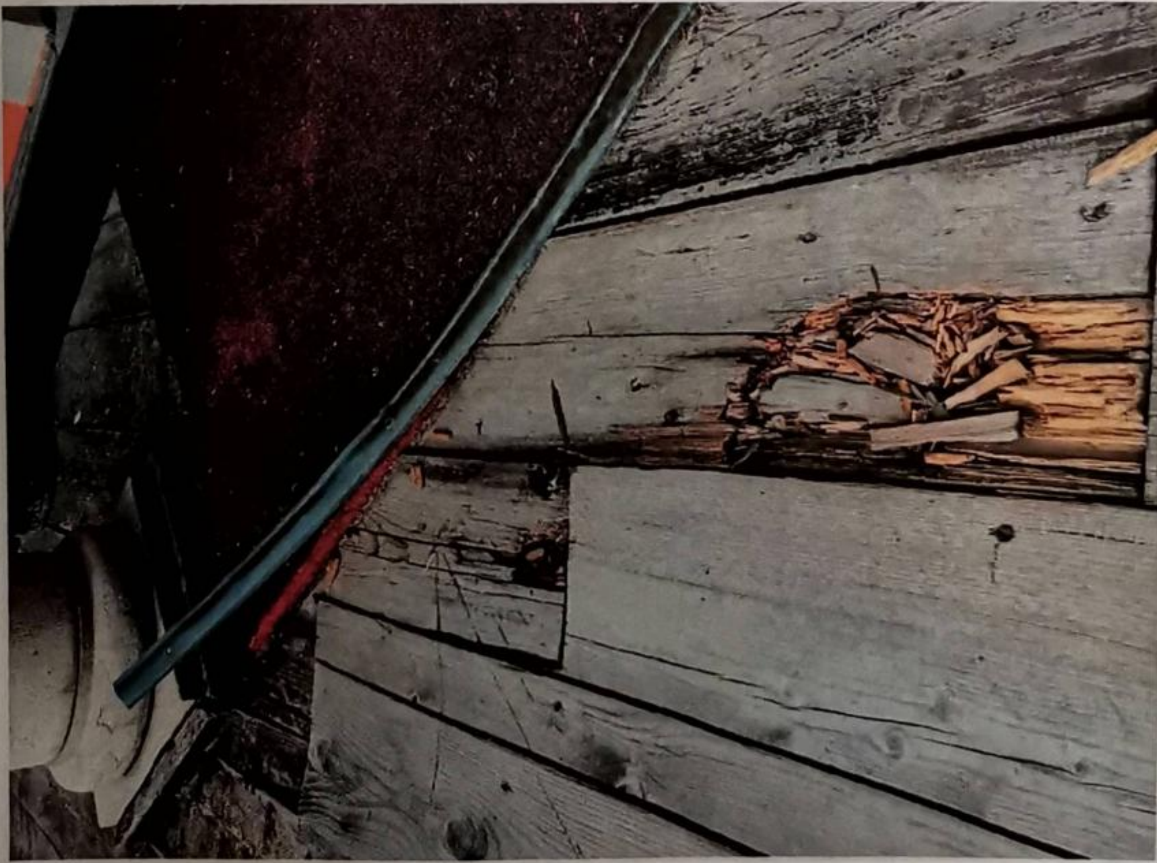
Foto 21 - Esterno - particolare marciapiiede marcio
