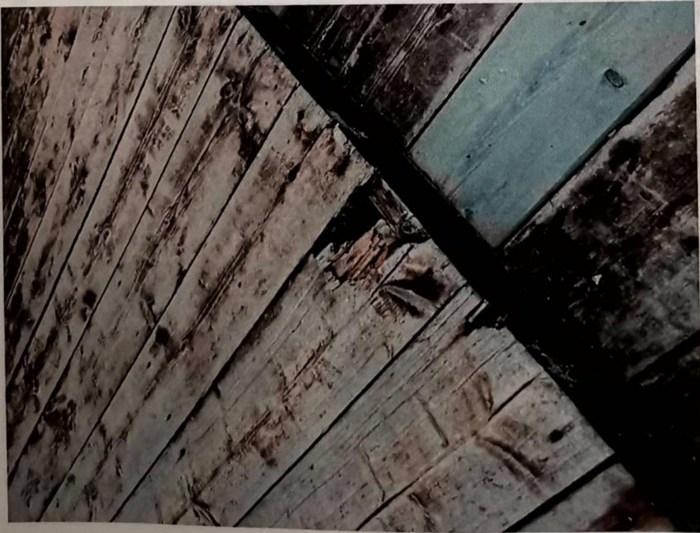
Foto 23 - Esterno - particolare marciapiiede marcio
