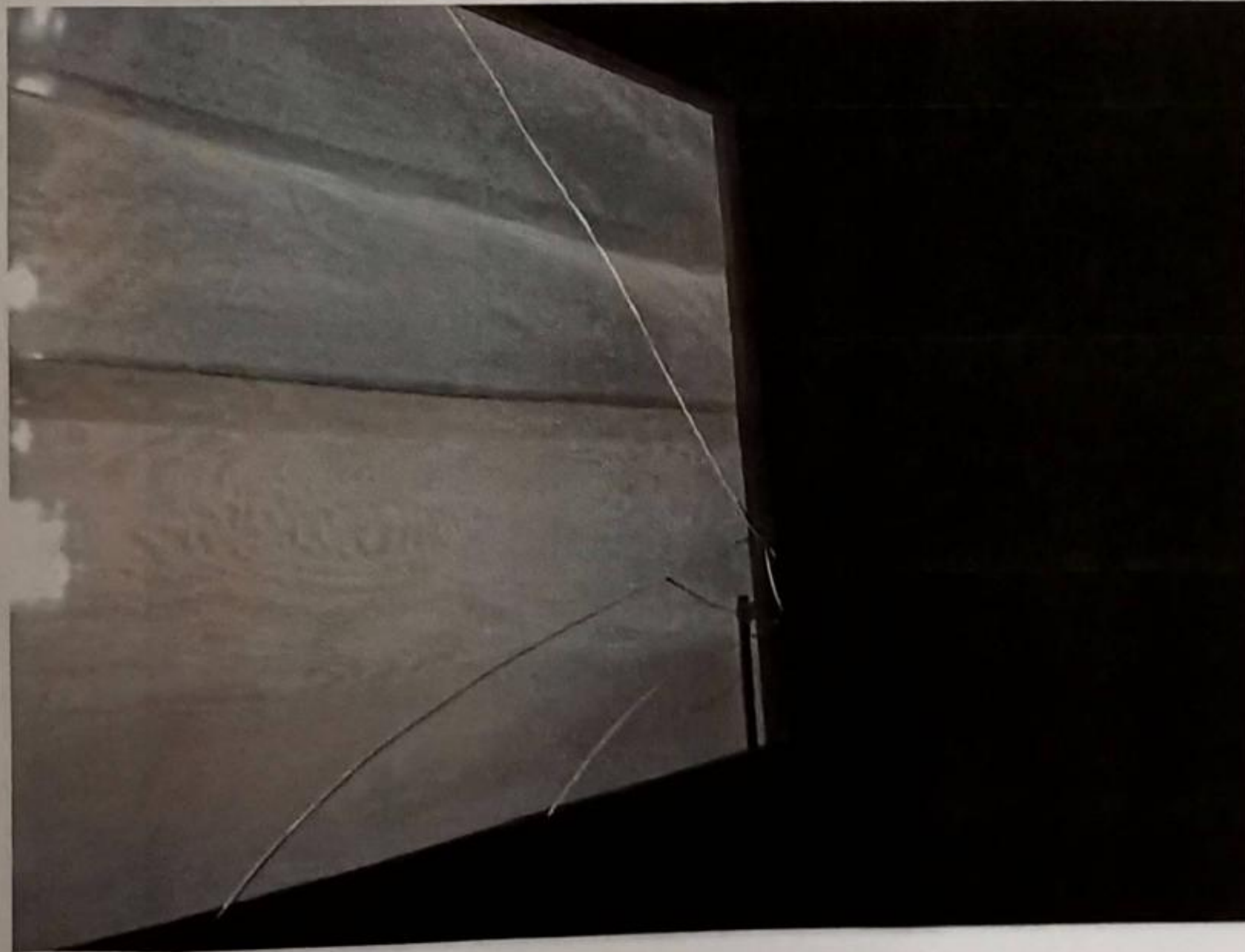
Foto 1 - Ristorante -vetrata della porta rotta
