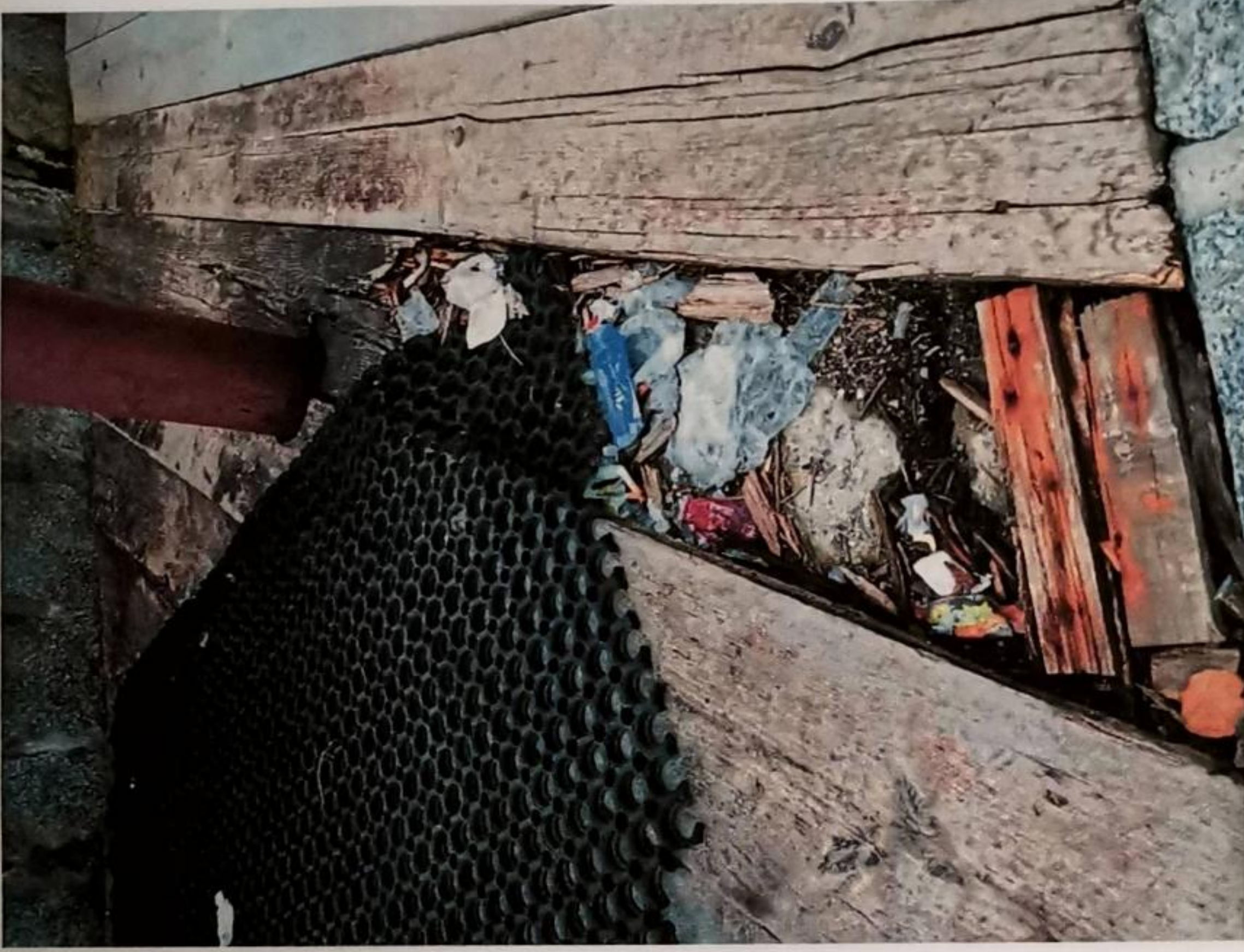
Foto 22 - Esterno- particolare marciapiede marcio
