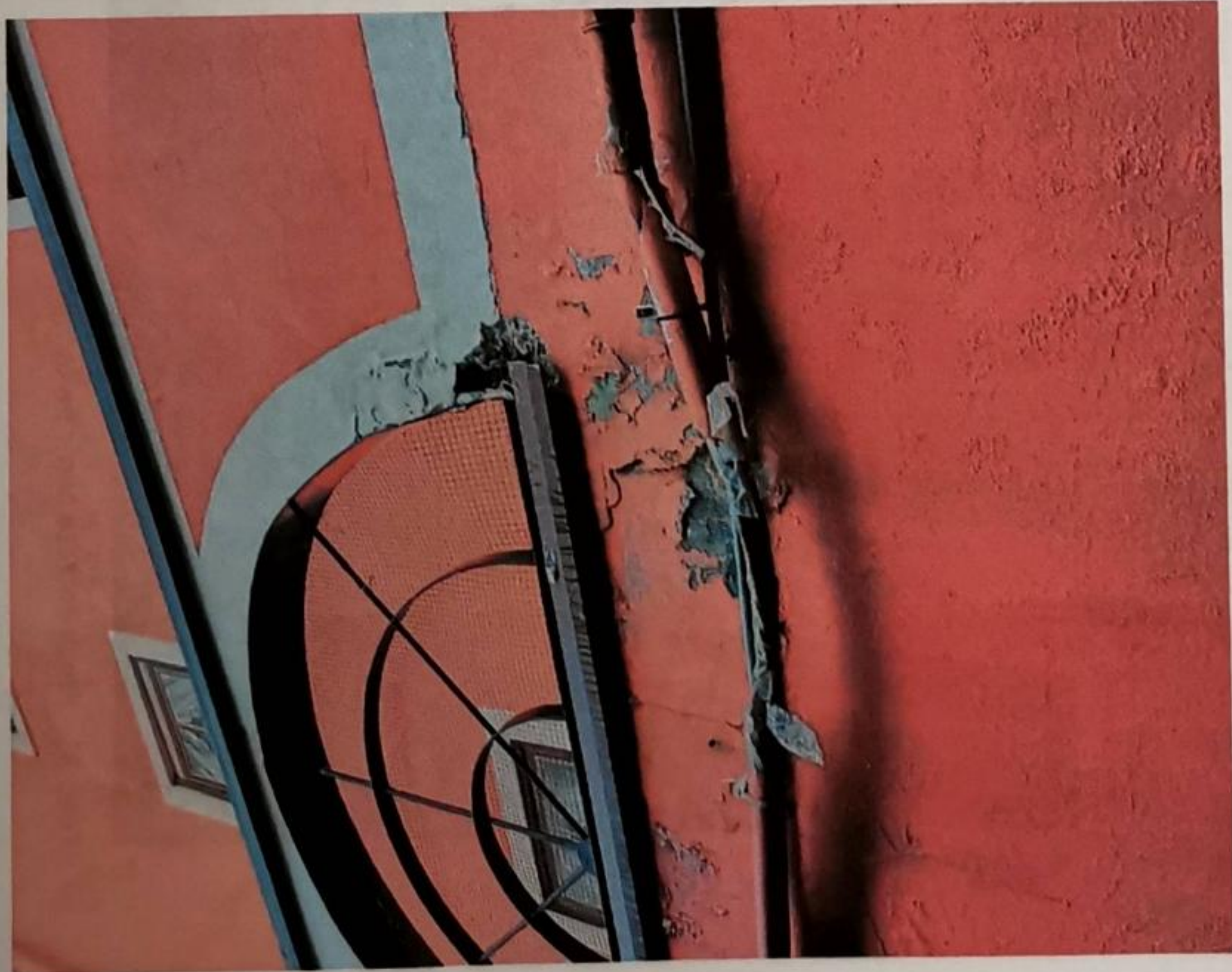
Foto 29 - particolare danneggiamento tubazione elettrica esterna
