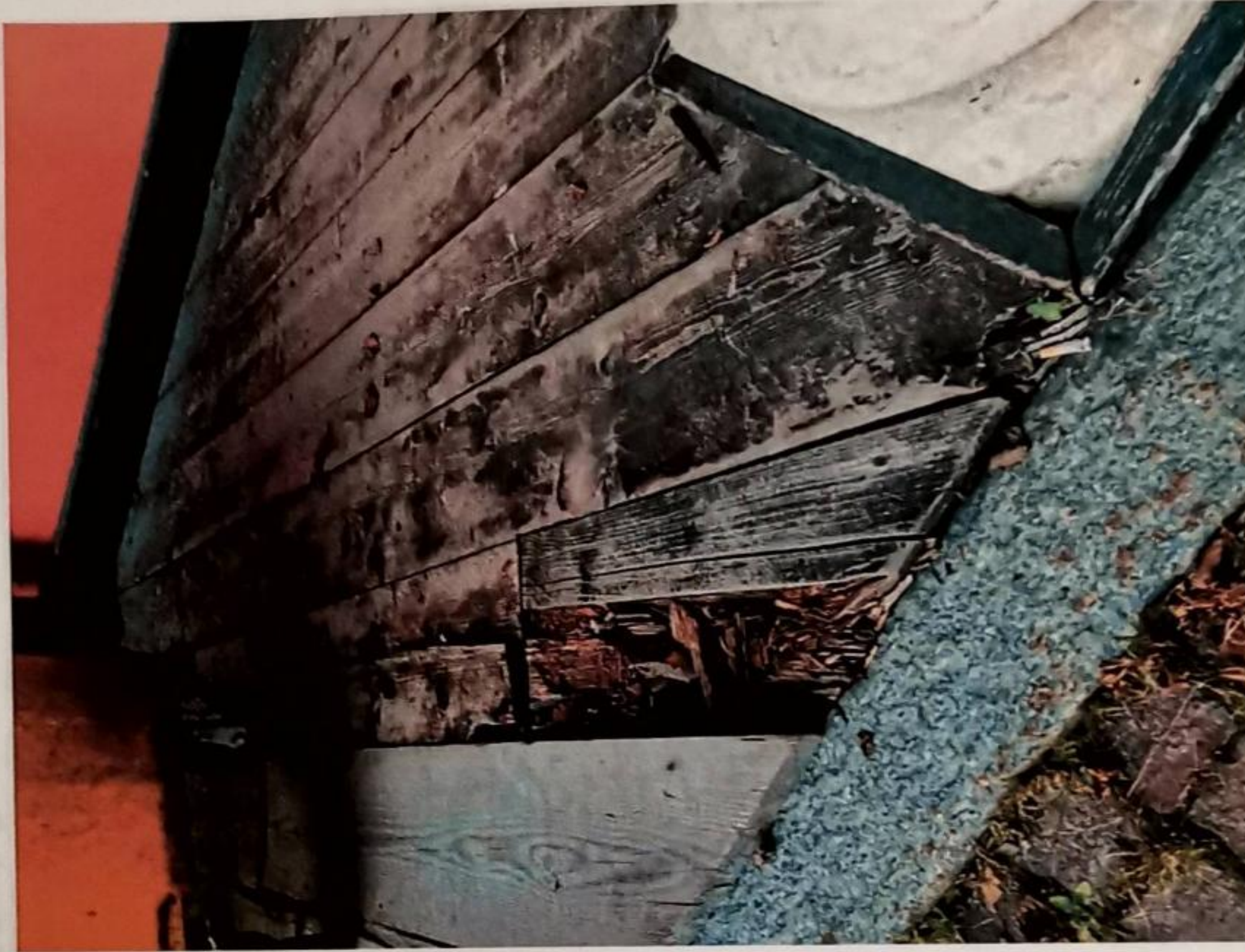
Foto 20 - Esterno- particolare marciapiEDE marcio
