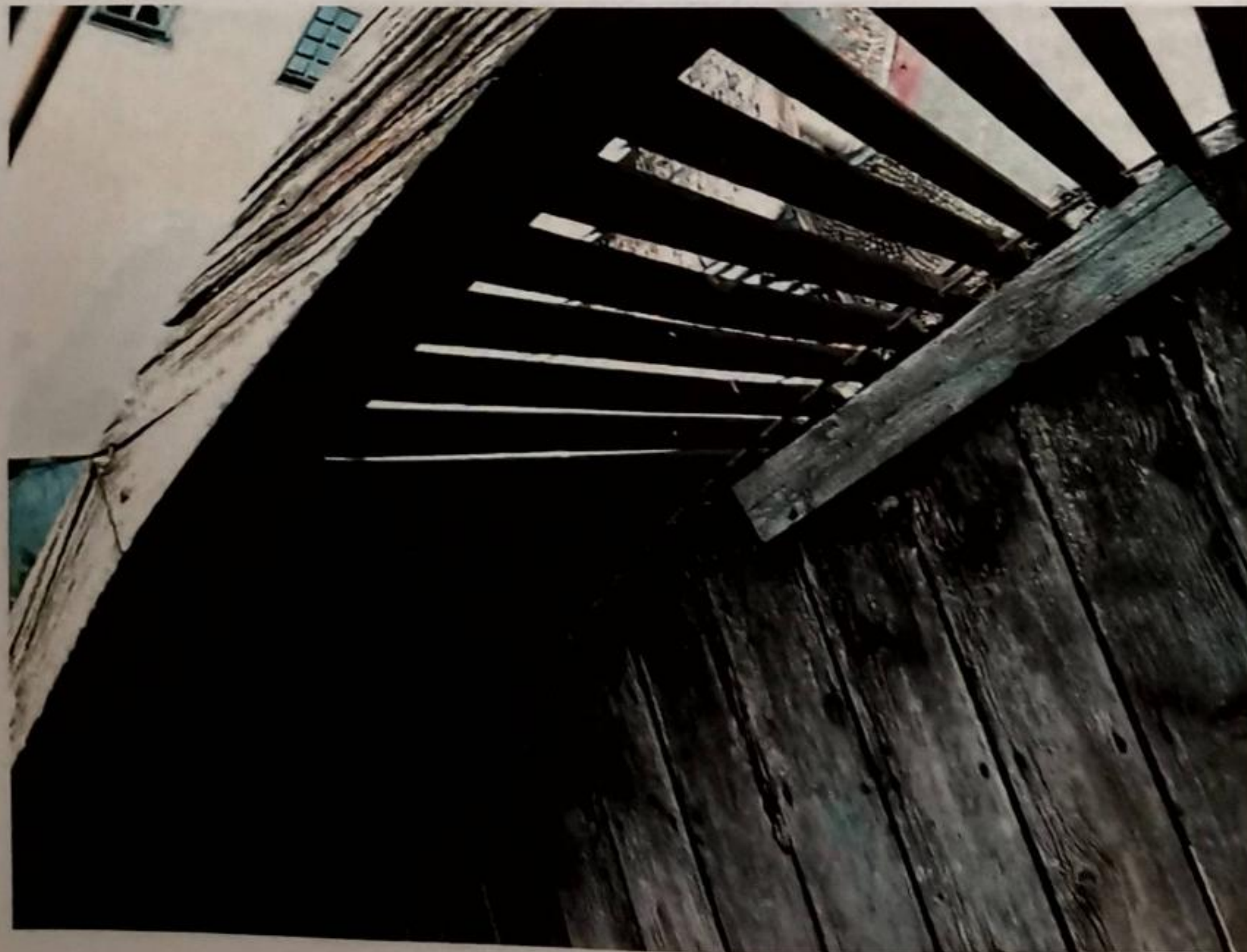
Foto 19 - poggolo con assito marcio e riparazione (?)
